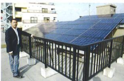
▲屋上に設置されたソーラパネル。会社で必要な電力の30%をまかなっている
